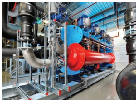
Pfizer Manufacturing Deutschland GmbH: quantum chilling unit.
